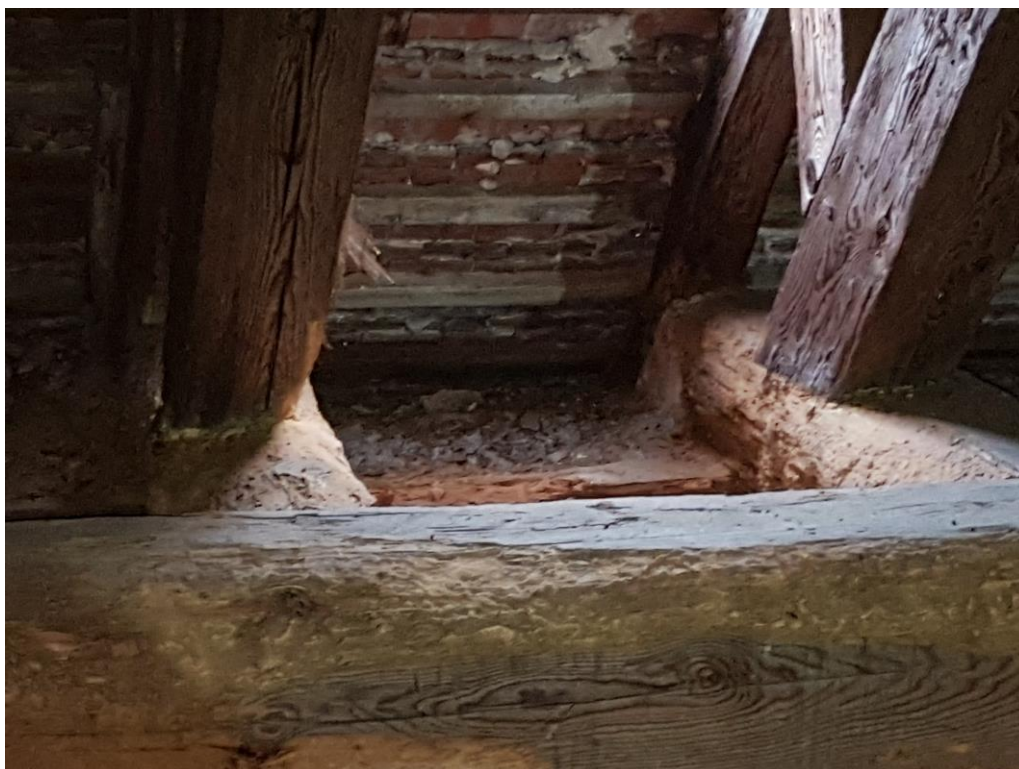
Fot. 36 – Przykład zniszczeń „kulawek” – widoczne zmurszenia elementu. Konieczne wzmocnienie elementów lub ich wymiana na nowe o takim samym przekroju i sposobie połączenia z pozostałymi elementami więźby dachowej (krokwią, przypustnicą i belką).
