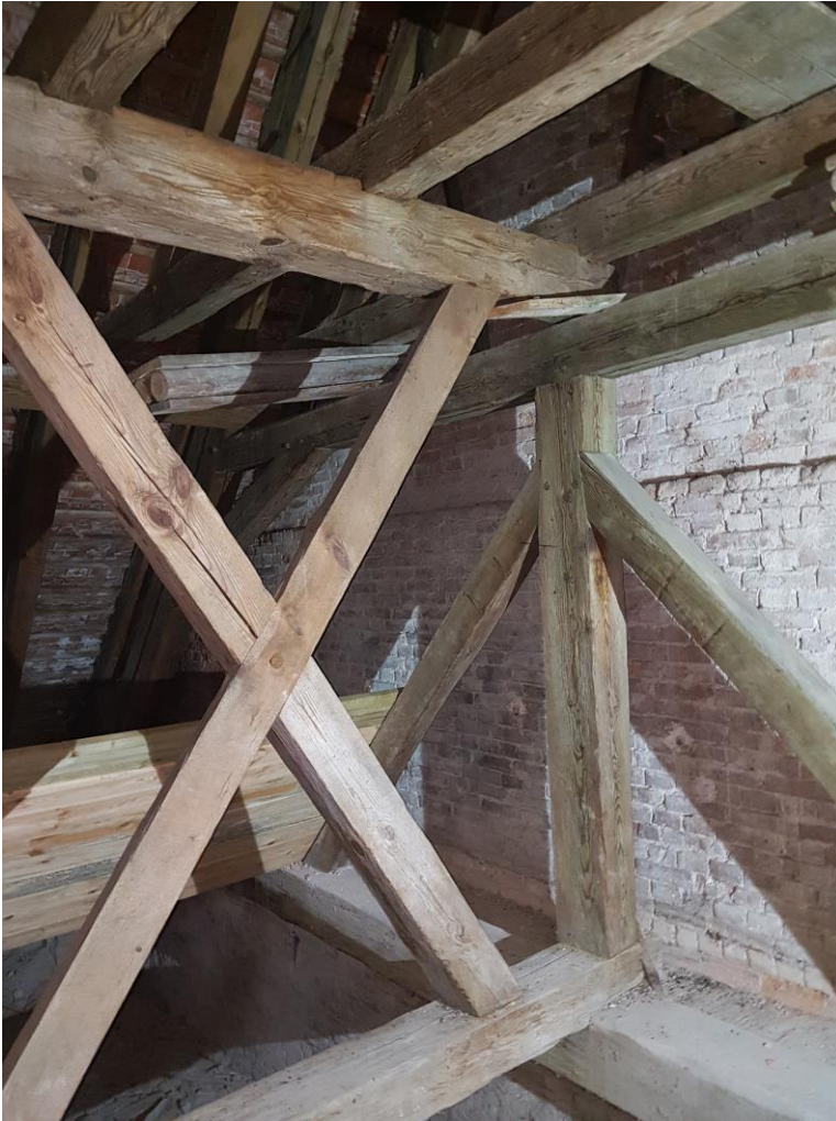
Fot. 24 – Widok ogólny więźby dachowej oraz ściany ceramicznej w obrębie poddasza. Z uwagi na porażenie szkodnikami drewna stan określa się jako niezadawalający.
