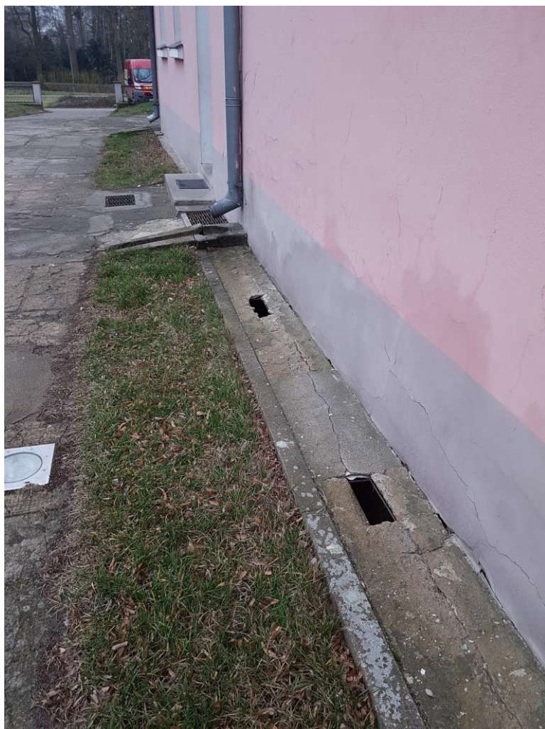
Fot. 20 – Spękania tynku cokołowego. W głębi widoczny brak opaski i kanału przy ścianie zewnętrznej budynku.
