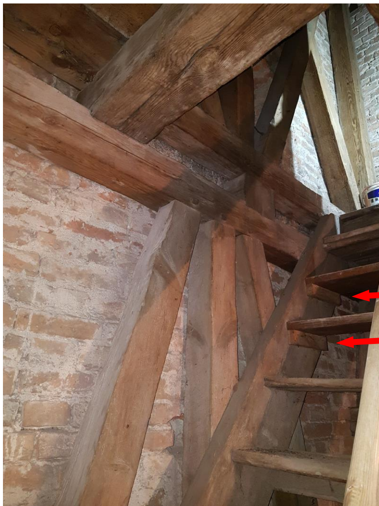
Fot. 47 – Widoczne ślady zacieków na konstrukcji drewnianej w obrębie wieży. Schody drabiniaste z uwagi na działalność szkodników drewna kwalifikują się do wymiany. W górnej części schodów widoczne doraźne naprawy poprzez wykonanie podpór dla stopni.
