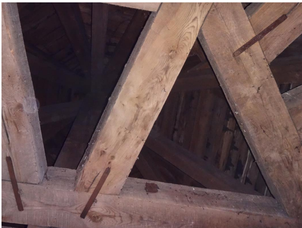
Fot. 49 – Konstrukcja hełmu – widoczne ślady zawilgoceń na deskowaniu przekrycia.
