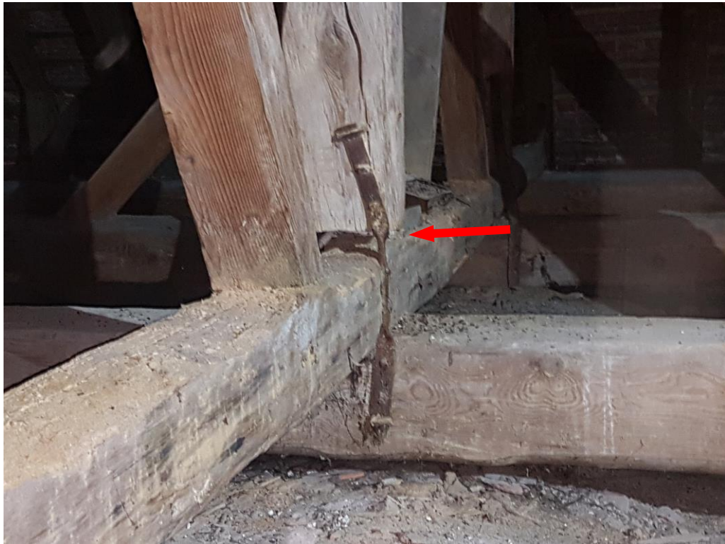
Fot. 38 – Przykład połączenia w węźle belki więzારowej, płatwie i stupa. Widoczne „wyhaczenie” stupa z gniazda na skutek ugięcia podwaliny i belki więzારowej. Należy sprawdzić jakość połączeń.
