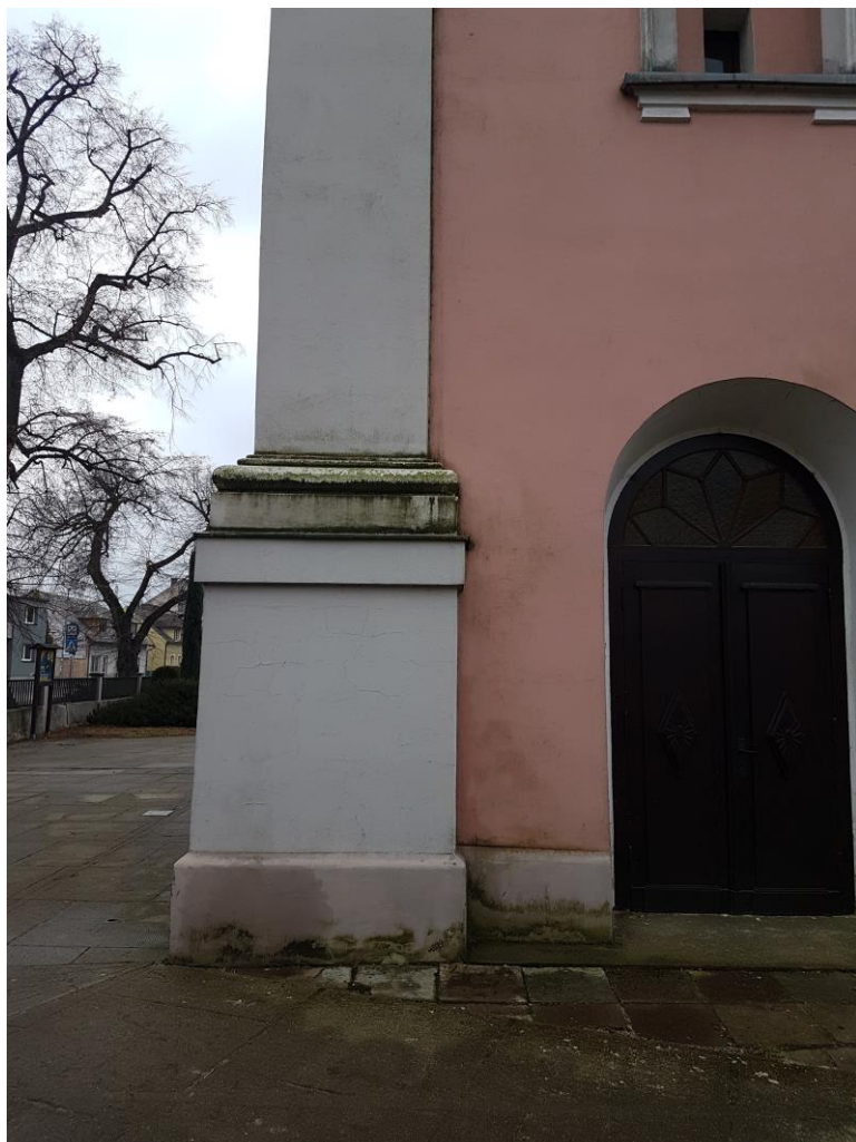
Fot. 18 – Korozja biologiczna na gzymsie i cokole budynku (wejście boczne w narożu północno wschodnim budynku).
