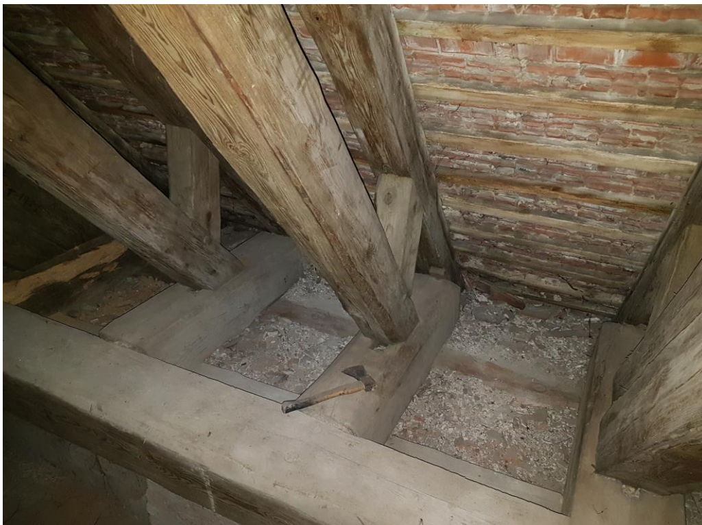
Fot. 31 – Stan konstrukcji drewnianej w części przyokapowej.
