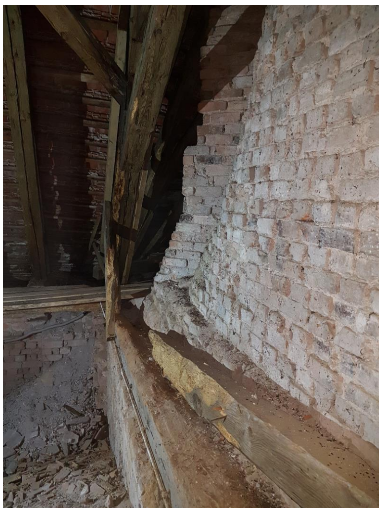
Fot. 35 – Przykład zniszczenia krokwi i podwaliny drewnianej – konieczna wymiana. Element w znacznej części zmurzały.
