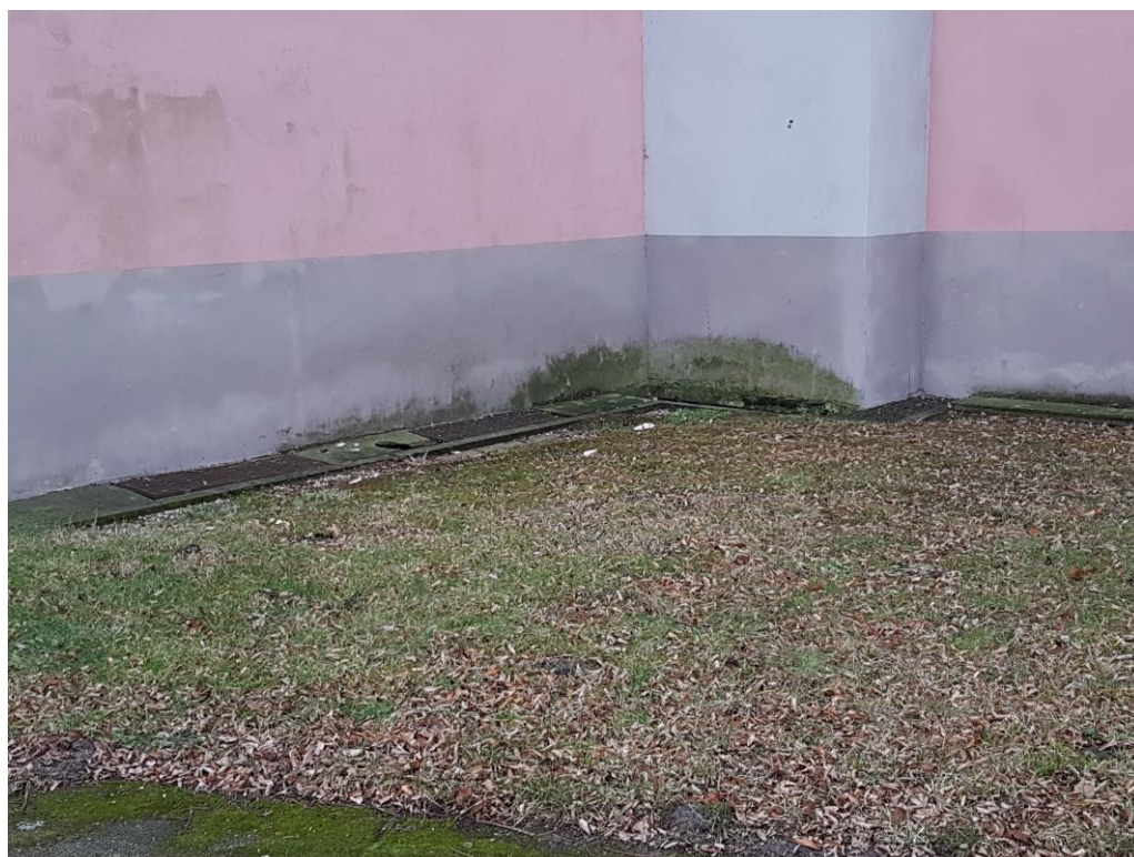
Fot. 19 – Przykład zawilgocenia cokołu.
