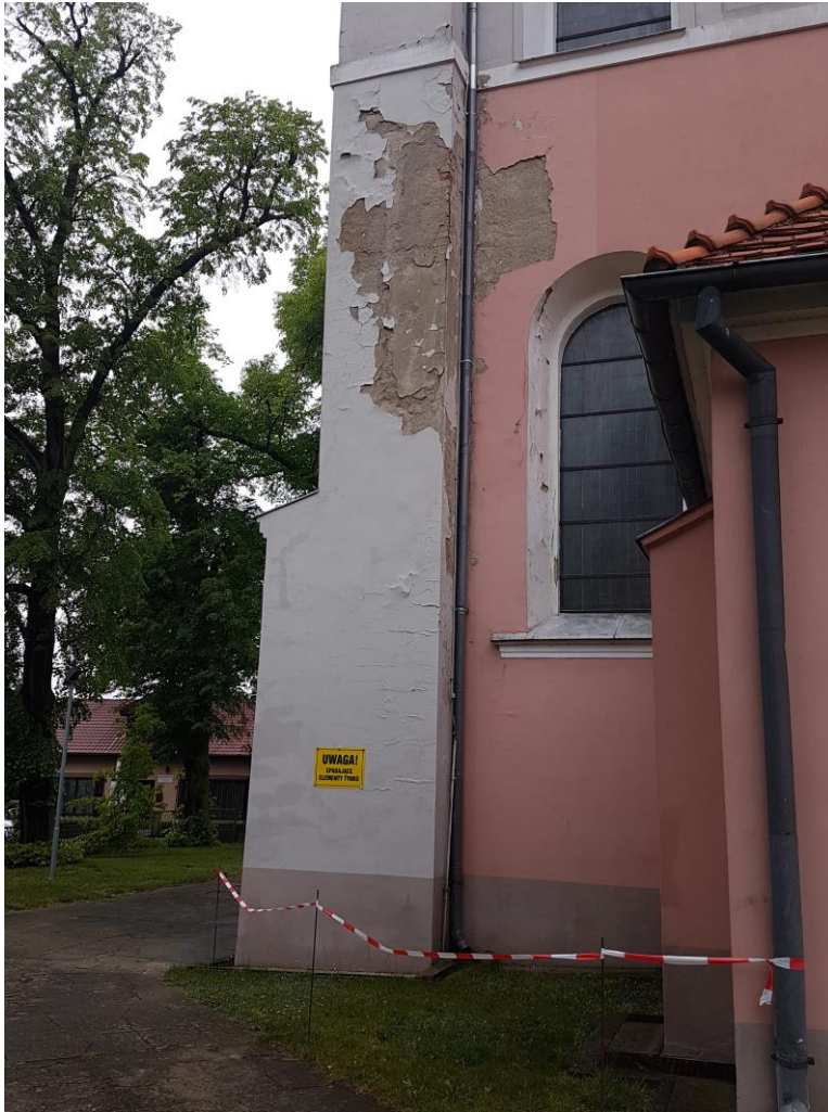
Fot. 12 – Zniszczenia tynku na pilastrze w narożu południowo-zachodnim powstałe najprawdopodobniej na skutek infiltracji wody z nieszczelnej rury spustowej. Widoczne wyгородzenie terenu przy budynku taśmą z uwagi na zagrożenie spadającymi fragmentami tynku.
