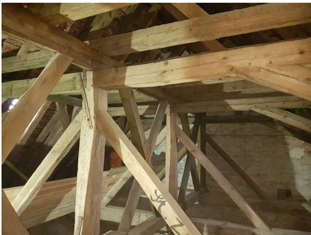
Fot. 26 – Kolejny przykład wizualnie zadowolającego stanu technicznego więźby dachowej.
