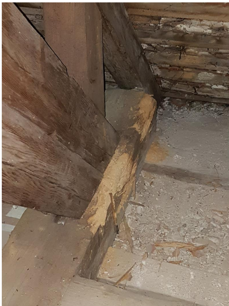
Fot. 41 – Kolejny przykład zmurszenia belki w części przyokapowej.
