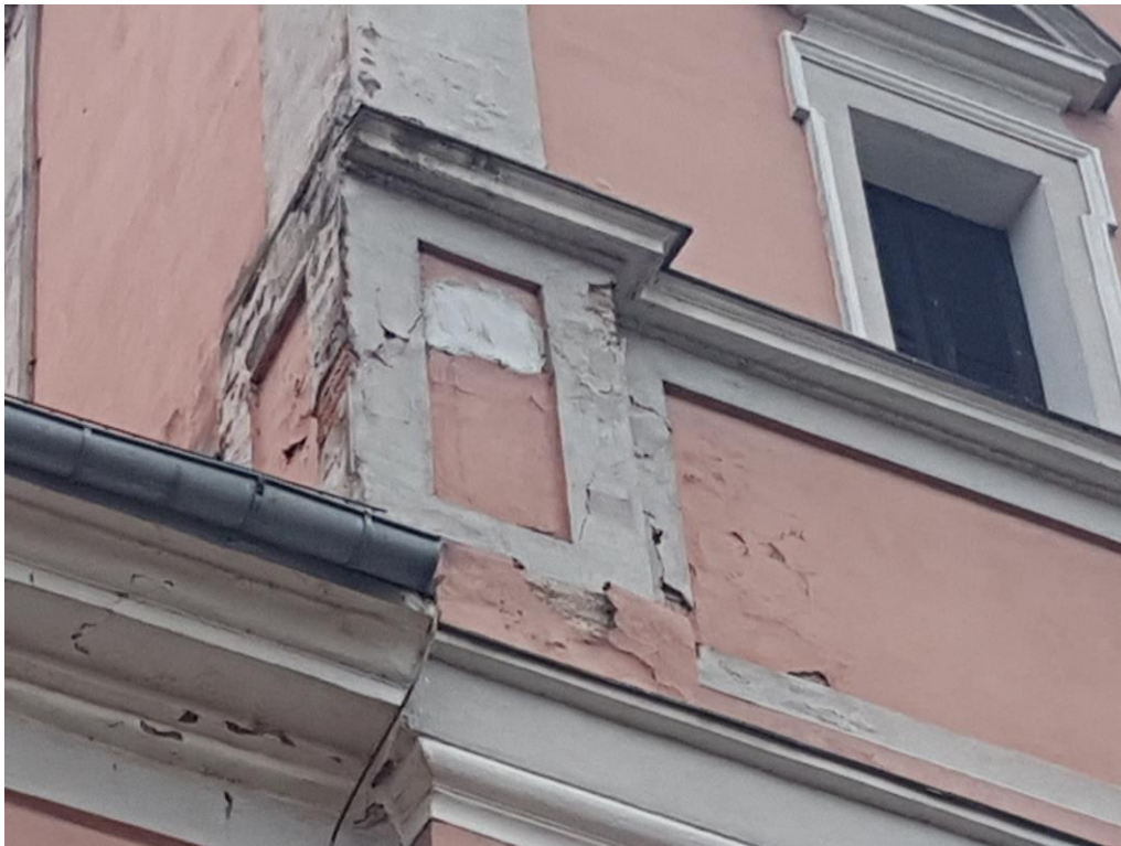
Fot. 13 – Zniszczenia tynku elewacyjnego wieży – naroże południowo zachodnie, rejon styku wieży z okapem dachu.
