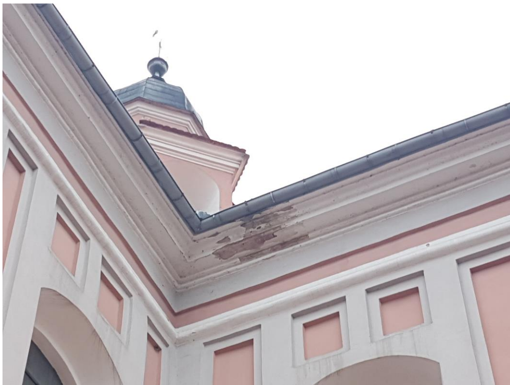
Fot. 14 – Zawilgocenie i ubytki tynku gzymsu na skutek nieszczelności rynny.
