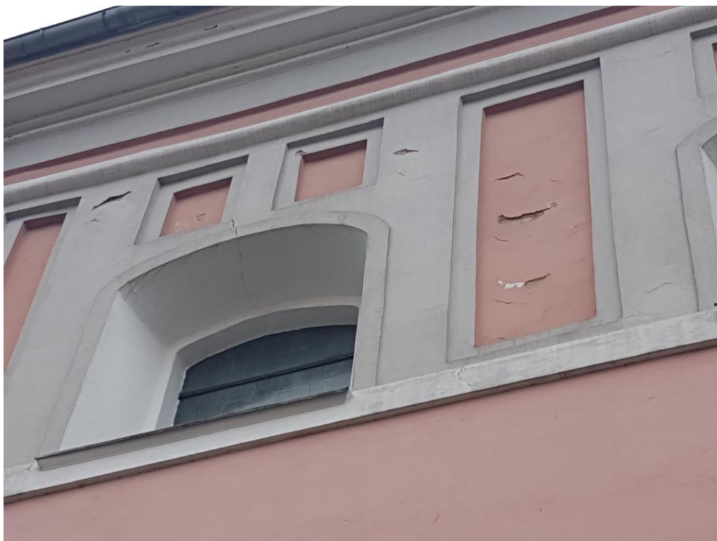
Fot. 15 – Kolejny przykład odspojenia tynku elewacyjnego.
