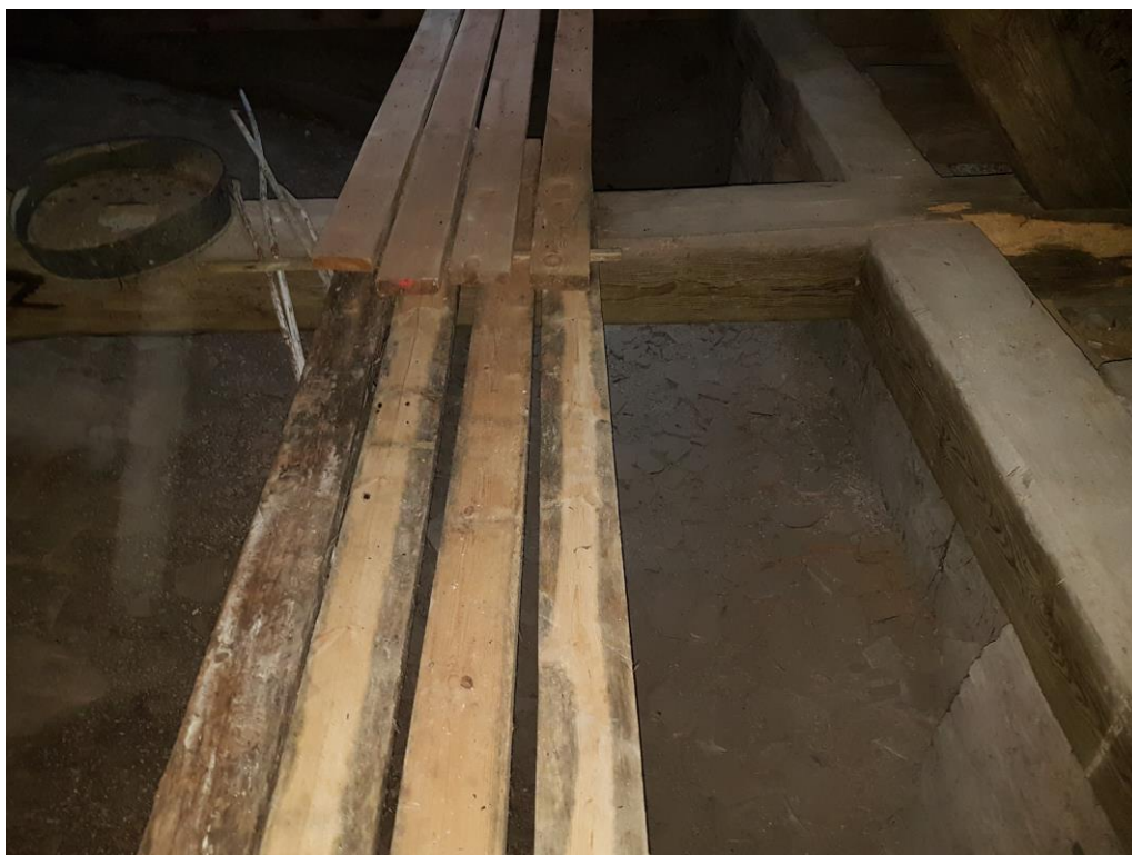
Fot. 44 – „Trakt komunikacyjny” na poddaszu, który stanowią luźno ułożone deski, nie spełniający podstawowych warunków dla jego bezpiecznego użytkowania.
