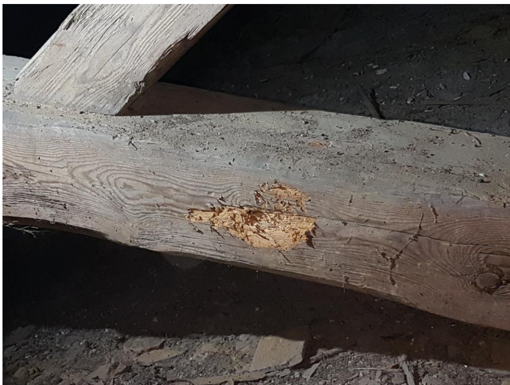
Fot. 34 – Lokalne powierzchniowe zmurzenie belki drewnianej – konieczne ociosanie oraz ewentualne wzmocnienie elementu (wzmocnienie uzależnione wielkością powstałego ubytku po ociosaniu).
