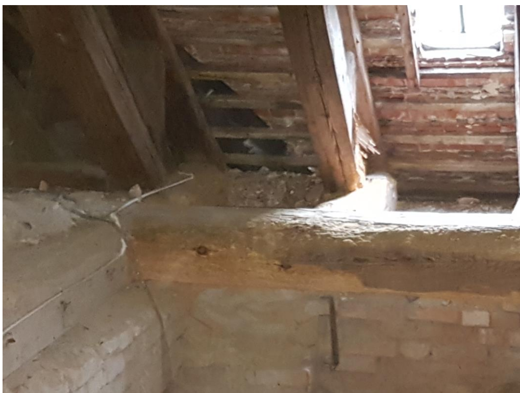
Fot. 37 – Kolejny przykład zmurszenia elementów więźby dachowej (krokwi, kulawki i belki). Sytuacja analogiczna do zaprezentowanej na fot. 35.
