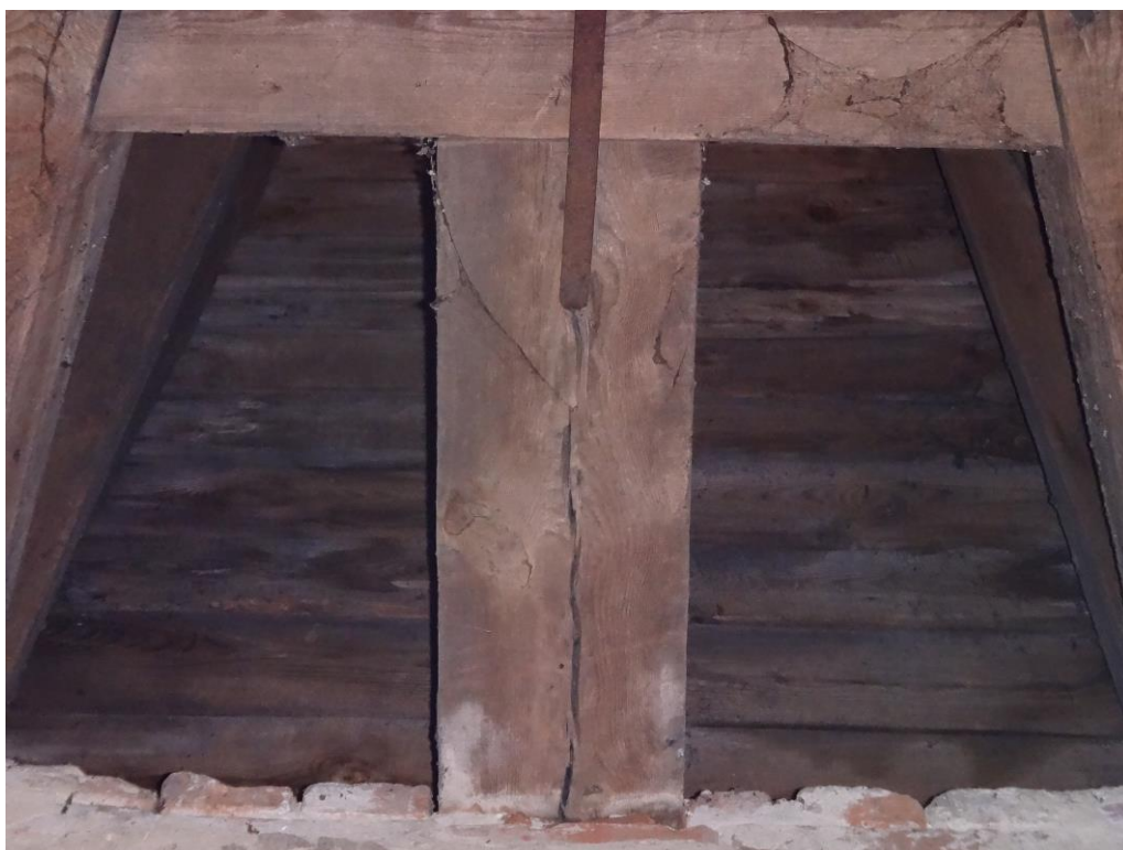
Fot. 50 – Ślady zawilgoceń i zbutwień drewna stanowiącego deskowanie hełmu, świadczące o nieszczelnościach w przekryciu wykonanym z blachy tytan-cynk.
