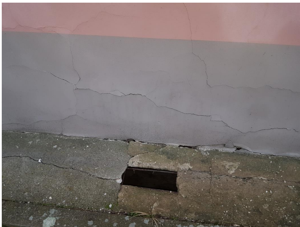
Fot. 21 – Szczegół spękań przekrycia kanału biegnącego wzdłuż ściany budynku oraz spękań tynku cokołowego – porównaj z fot. 19.
