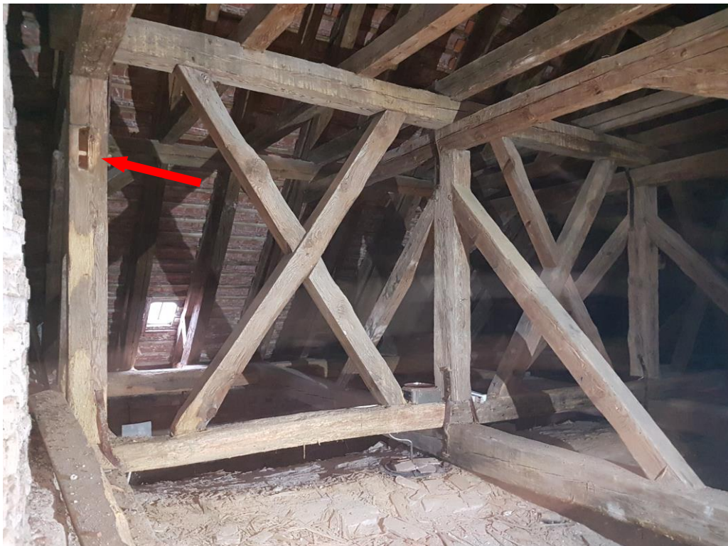
Fot. 30 – Kolejny przykład stanu więźby dachowej – strzałką zaznaczono brak miecza, który należy uzupełnić w ramach remontu.
